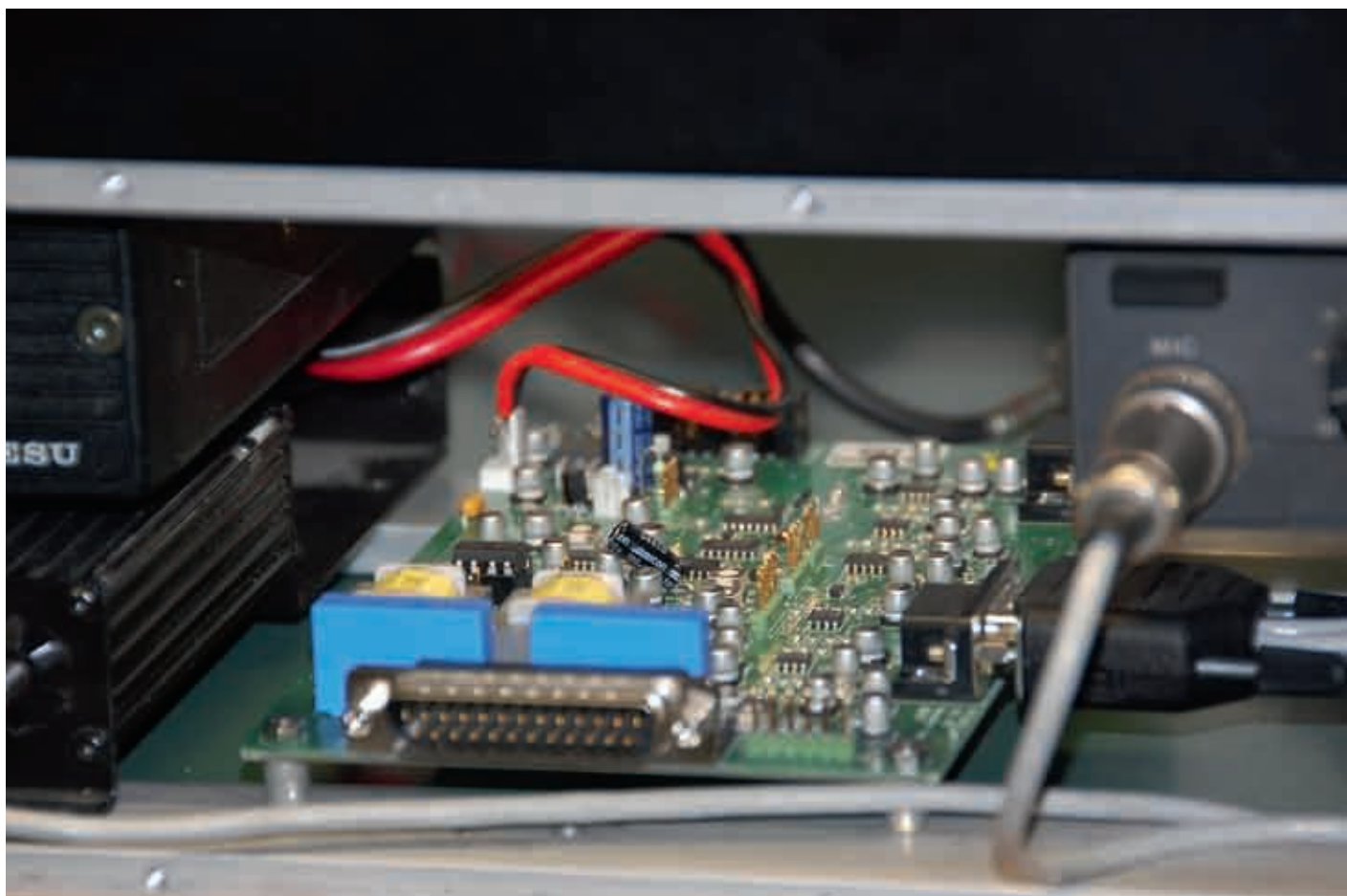
Repeatern i Göteborg består av två mobilstationer, ett filter, strömförsörjning och detta logikkort som är själva hjärnan.
